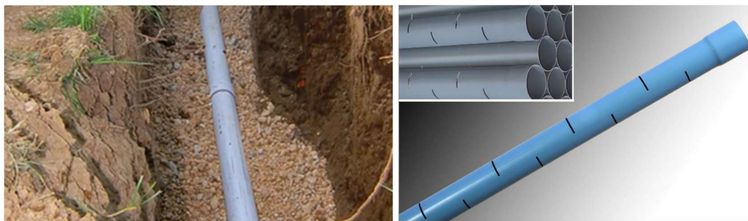
Foto 2: Imagen referencial tubería de PVC 110 ranurada instalada sobre gravilla.
